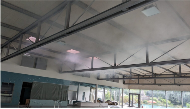
Abbildung 6: Verteilung der Zuluft unter der Decke
